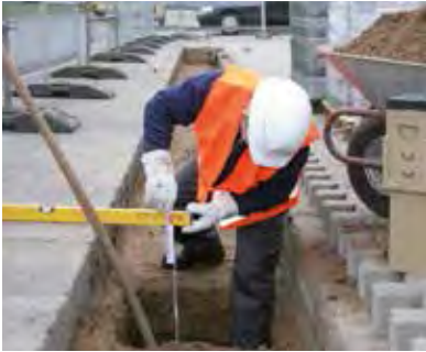
1. Udgrav rende til svarende valgte liniedræn type. Vær opmærksom på placering af udløb.
