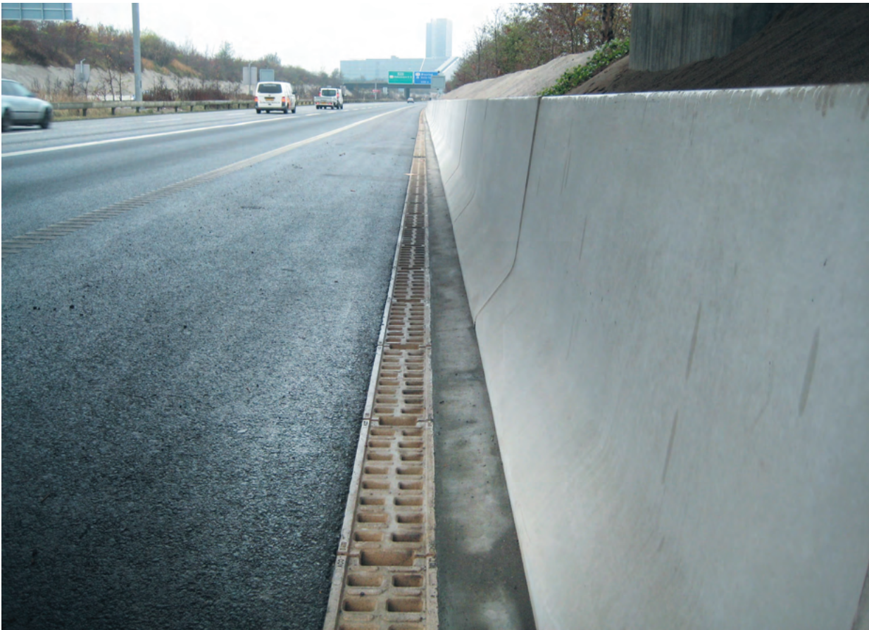
ACO MONOBLOCK RD 200 monteret ved Øresundsmotorvejen.
